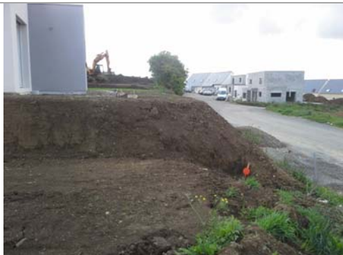
Terrassement en remblais excessifs créant des vues sur la parcelle inférieure
