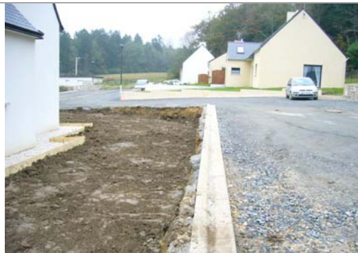
Terrassement en déblais détériorant la structure des chaussées
